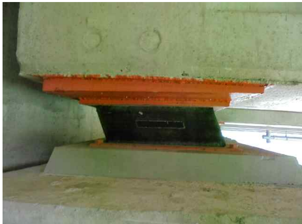
A2-Sh2 받침콘크리트 파손(0.1×0.1)
