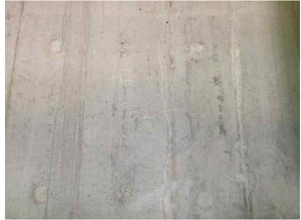
교대 A2 흉벽 균열(Cw=0.3mm미만)
